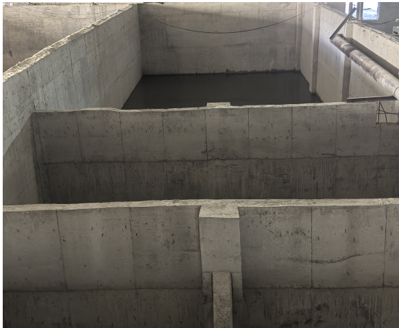
湿法制砂生产线配套沉淀池
