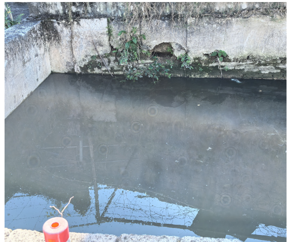
已建初期雨水池
