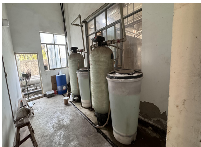
现状原有 1 软水制备系统
