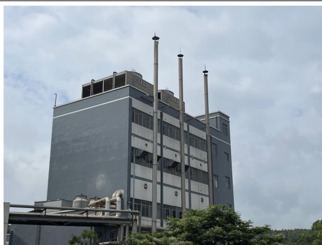
天然气锅炉房排气筒
