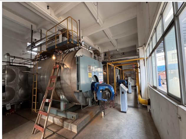
现状原有 3 个燃气锅炉
