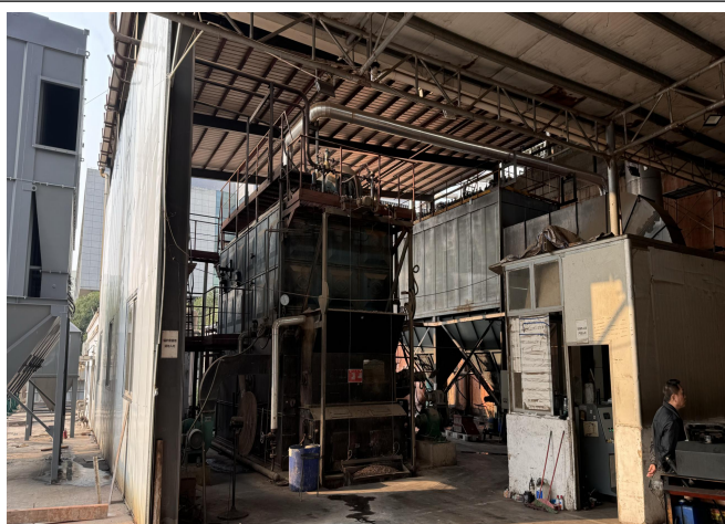
项目原有的 6t/h 燃生物质锅炉
