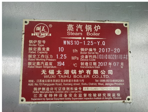
项目天然气锅炉铭牌
