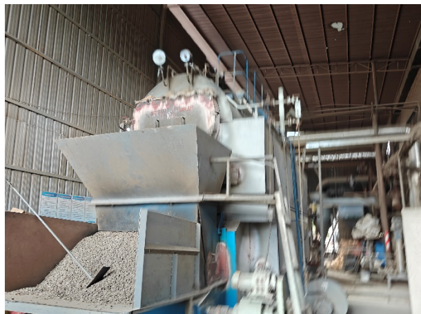
项目生物质燃料锅炉
