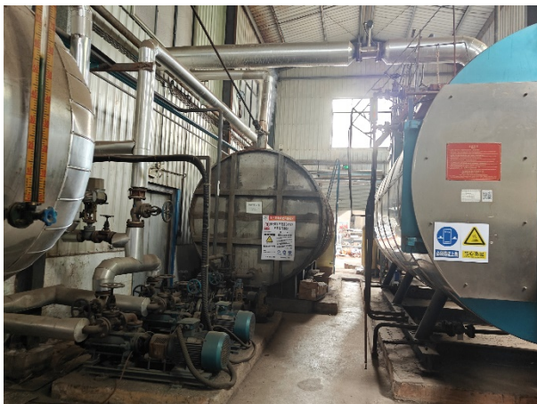
项目天然气锅炉
